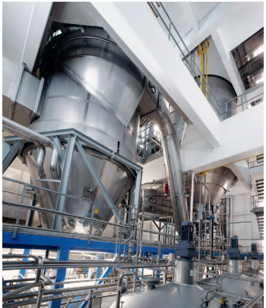
Nutritec AG, Sprühtrockner, Kostensenkung durch umfassende Energieanalyse (Pinch-Technologie)
